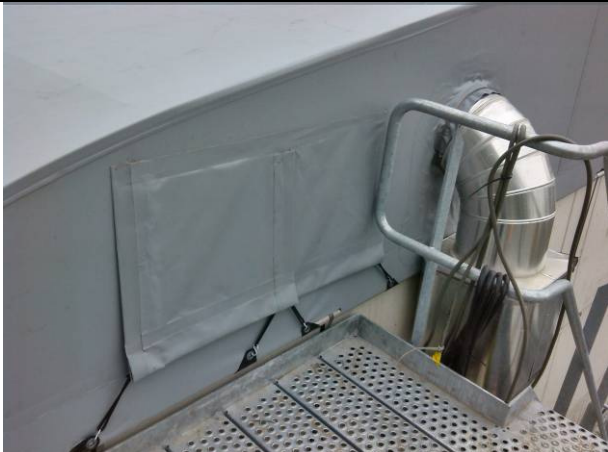
Inspectie luik en doorvoer
